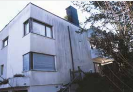
Algenbewuchs an Nordfassade
