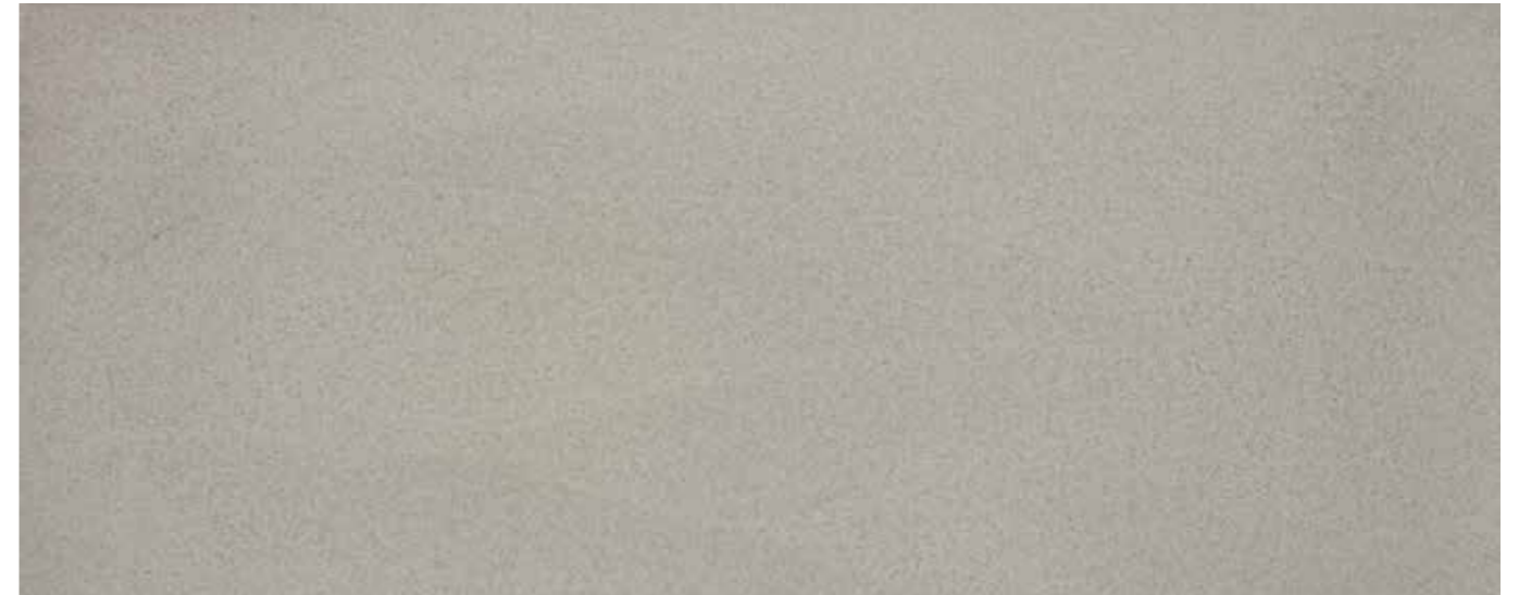
PANDOMO Floor Bodenfläche behandelt mit: PANDOMO SP-SL Steinöl, PANDOMO SP-F Porenfüller und PANDOMO SP-GS Seidenglanz-Siegel
